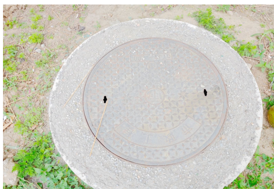
项目内下水检修井
