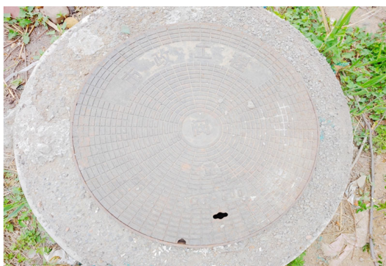
项目内上水检修井
