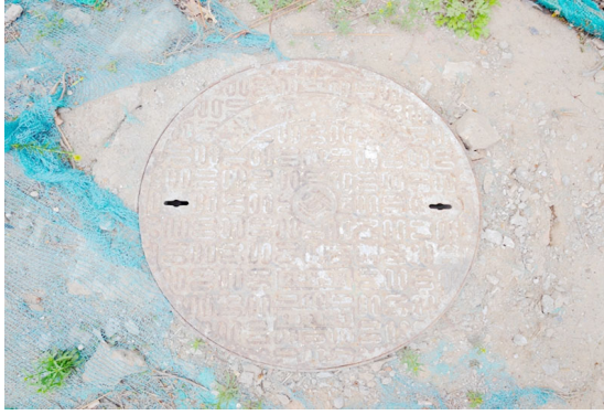
项目内通信检修井
